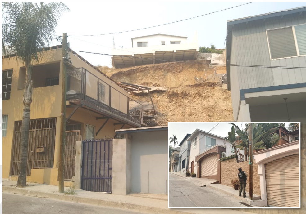
VISTA FRONTAL DE DERRUMBE DE TALUD. Se observa zona de desprendimiento que afecta directamente a tres viviendas de la calle Huajuco.
