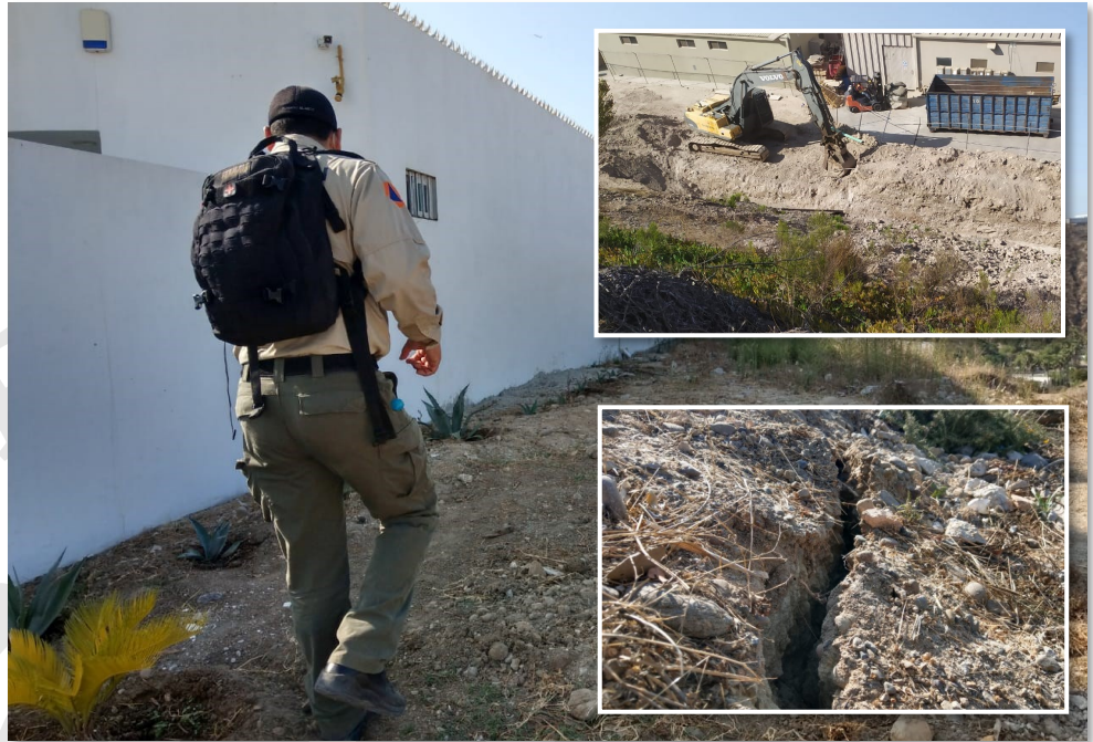
ASENTAMIENTO DE TERRENO. Excavación al pie del talud del terreno afectado.
